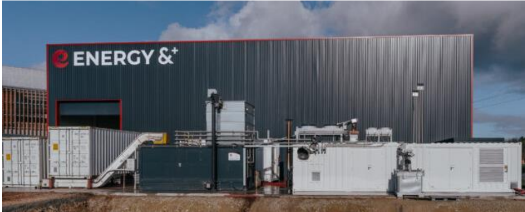
Figure 33 – Photographie des modules de pyrogazéification installés à Yangambi (crédit image : Energy&+)
